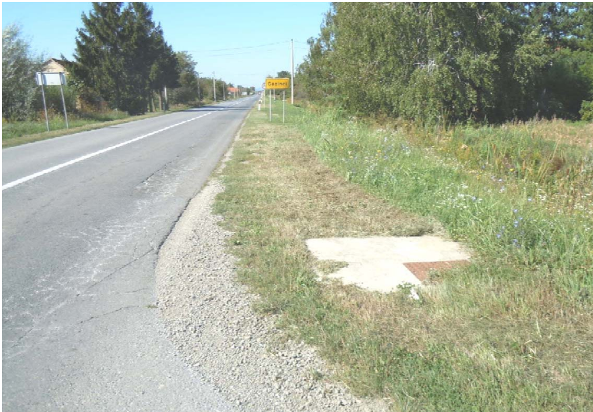
Slika 3. km 20+480; detalj kolnika – propadanje ruba konstrukcije, mrežaste pukotine
