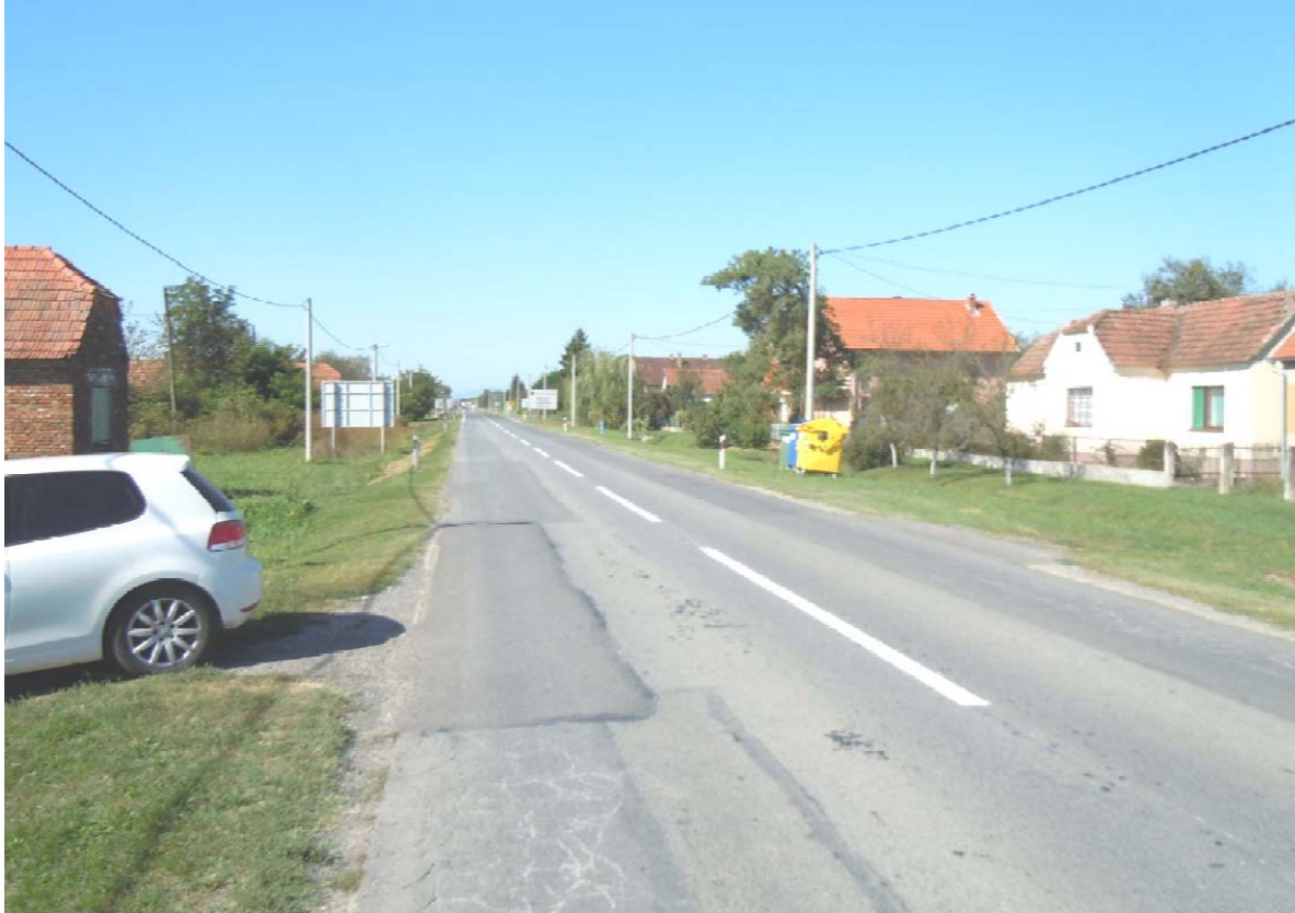
Slika 2. km 20+150; detalj kolnika – mrežaste pukotine
